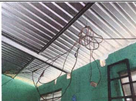
Foto 14: Sustrucción del cableado de energía eléctrica del aula 6
